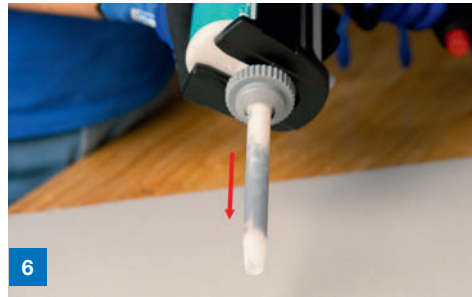
6 Befüllen des Statikmischer mit Klebstoff. Homogenität der Mischung prüfen (siehe Verarbeitungsbegleitende Qualitätskontrollen 2K-Produkte)
