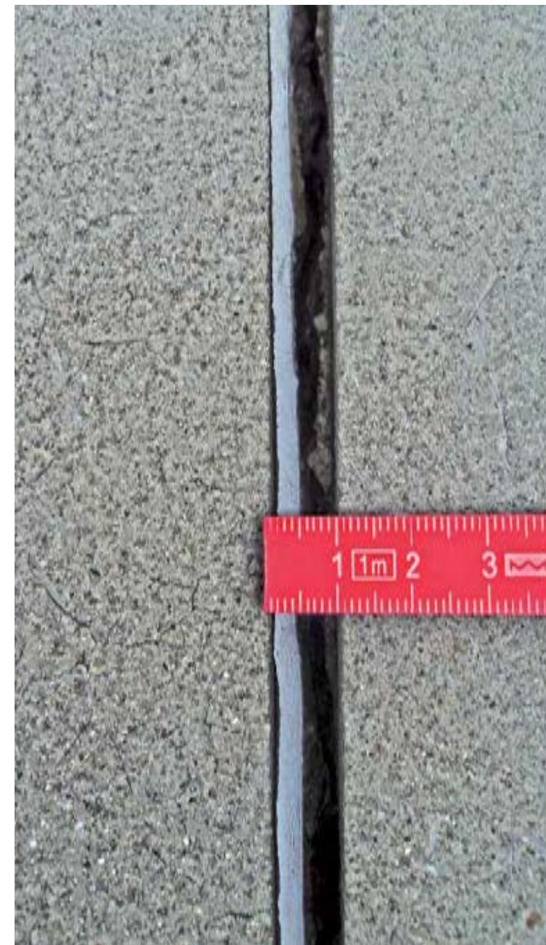
Riss der Fugenmasse durch falsche Fugendimensionierung.
