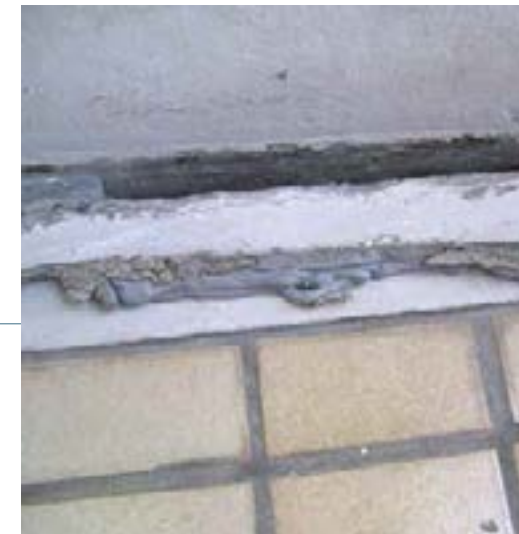
Schadhafte Fuge am Balkon: falscher Dichtstoff, falsche Ausführung.
