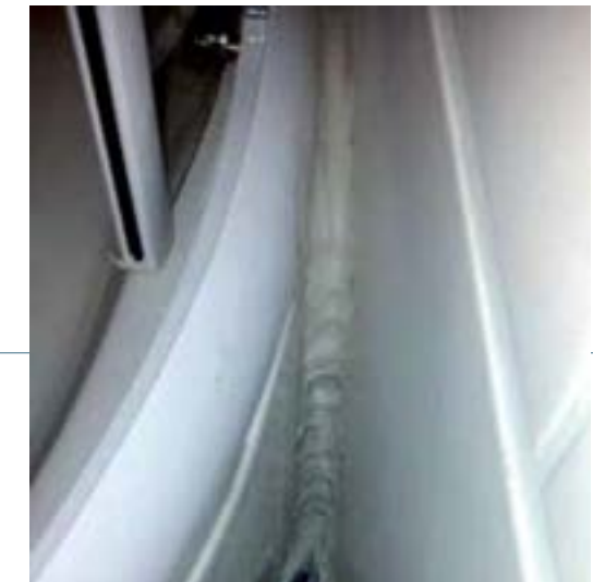
Misslungene Abdichtung einer Duschwannenschürze zur Fliese.
